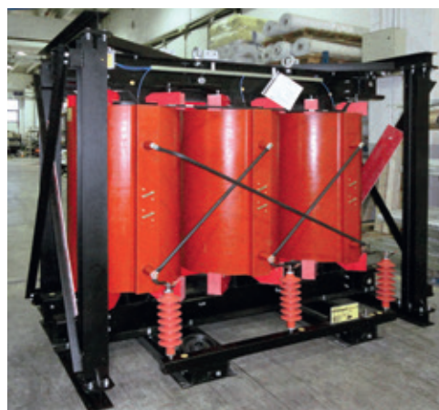
Пример сейсмостойчивого трансформатора
